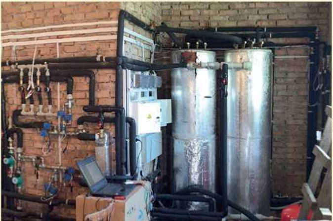
Буферные бойлеры и модуль интеграции с существующей системой отопления
