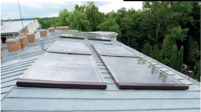
Стеллаторное поле системы Polarsol, установленное на кровлю здания
