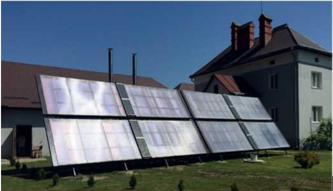
Стеллаторное поле системы Polarsol, установленное на фундамент рядом со зданием
